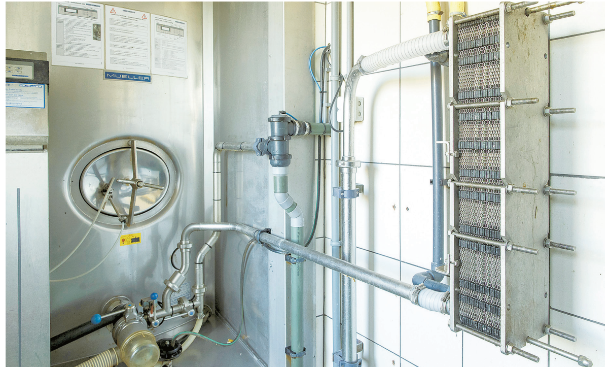
Beeld van het tanklokaal, met voorcoeler en koelmachine. Werkt die combinatie optimaal, dan levert dat een energiebesparing op van 75 procent.
